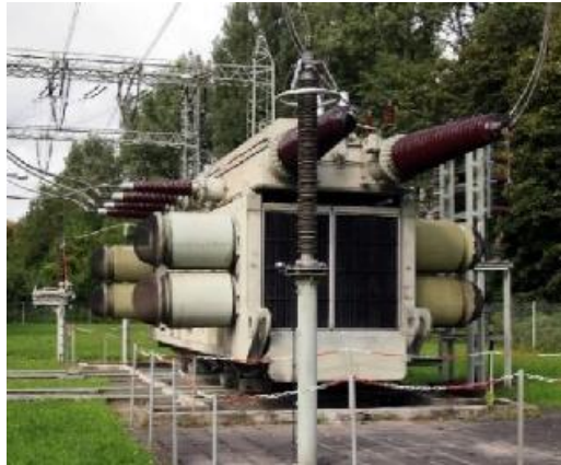
Gambar 22. Transformator Step-Up (Sumber: Wikimedia)
