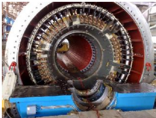
Gambar 2. Generator di dalam PLTA
